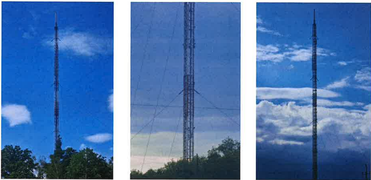
Widok obiektu wraz z zainstalowanym zespołem antenowym
