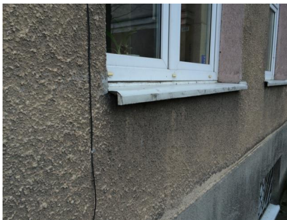
Rys.13. Istniejące parapety zewnętrzne
