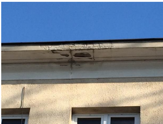
Rys. 14. Istniejące skutki nieszczelnego opierzenia gzymsu pod-rynnowego
